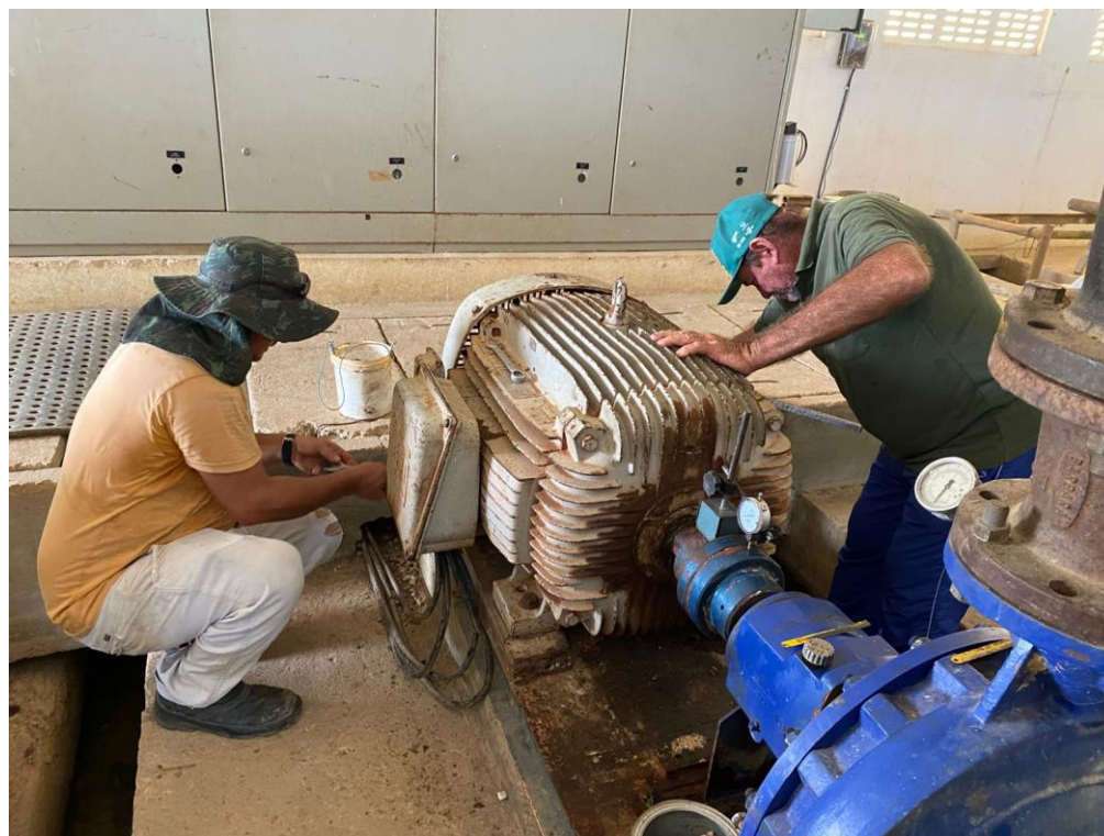
Figura 14 – Alinhamento motor EB 10.
